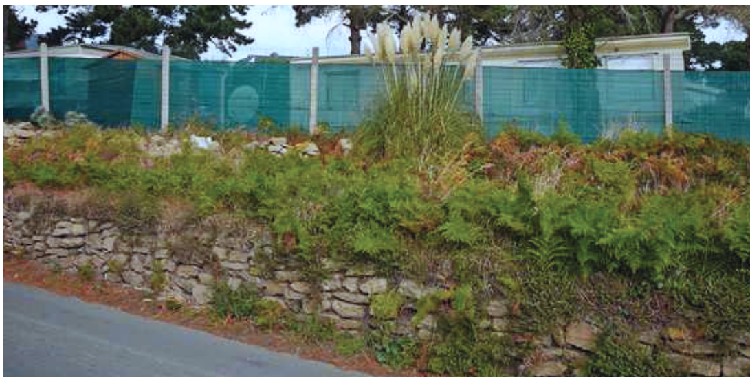
Au-dessus d'un beau mur-talus ancien se détache une clôture en bâche plastique tendue sur des poteaux en béton. Cette solution est à proscrire pour son atteinte au paysage.
